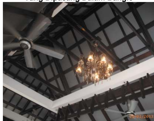
Gambar 3.11 Sebahagian Peralatan Elektrik Yang Dipasang Dalam Banglo
